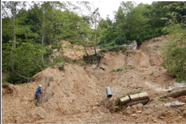
治山施設の損壊（飯豊町高峰）
