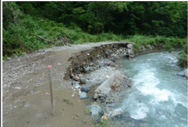
林道擁壁の損壊（飯豊町東沢線）
