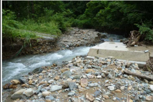
林道の路体流出（飯豊町東沢線）
