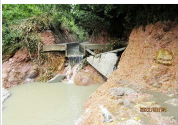
用水路の流出（小国町金目）
