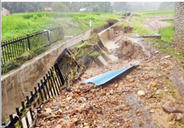
排水路の破損（飯豊町椿）
