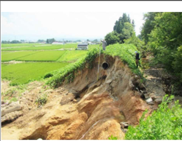
用水管の崩落（川西町下小松）
