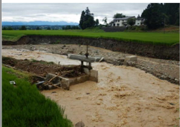
頭首工の流出（飯豊町萩生）
