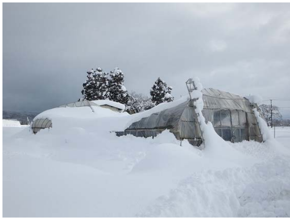
③ パイプハウス全壊（長井市） 平成 29 年 1 月 16 日撮影
