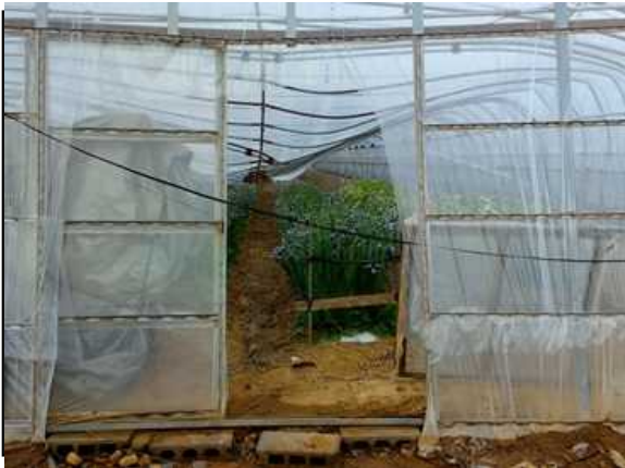
写真①変形したパイプハウス
