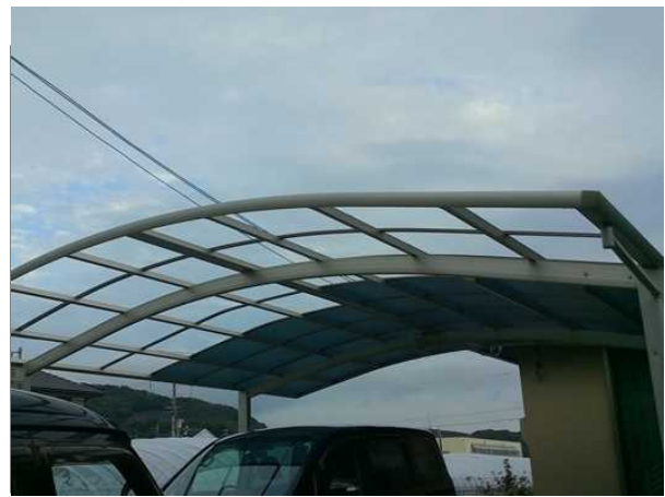
写真④屋根パネルが破損した カーポート
