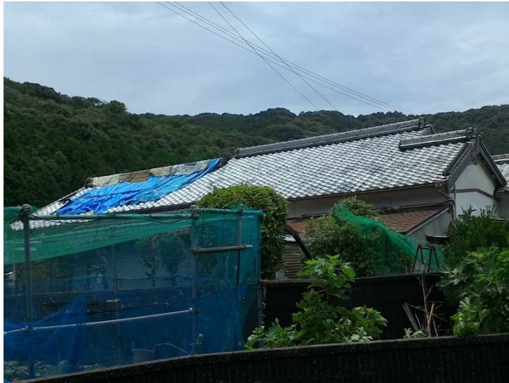
写真① 屋根瓦がはく離した住家 (北西方向から撮影)
