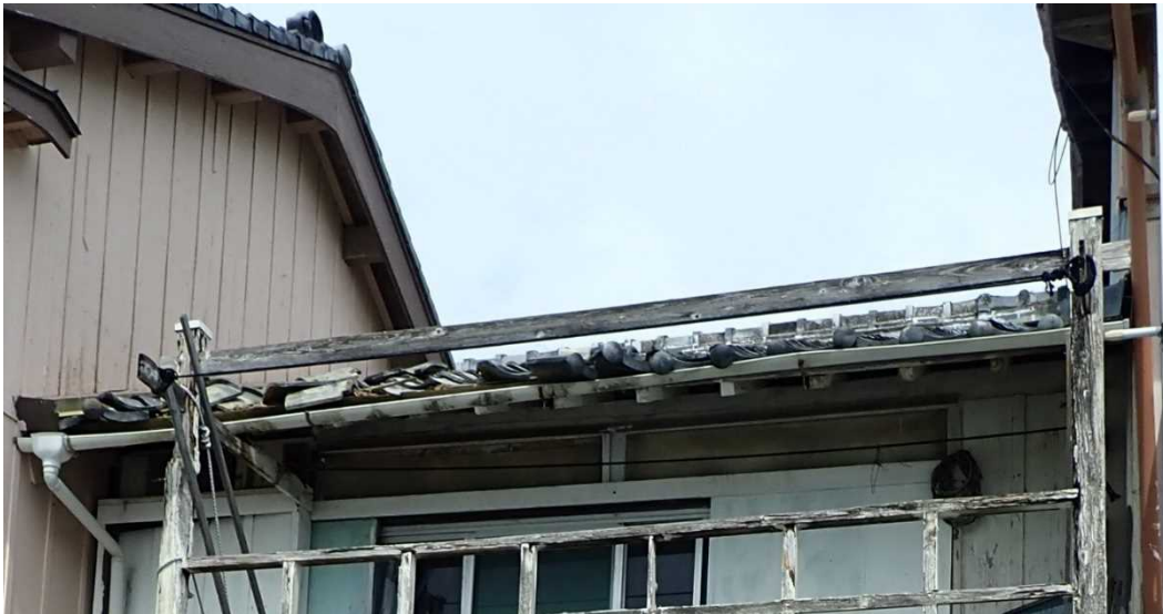
写真① 瓦がはく離した住家 (西方向から撮影)
