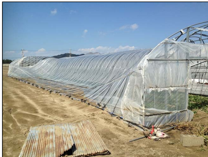
倒壊したパイプハウス（和歌山市）
