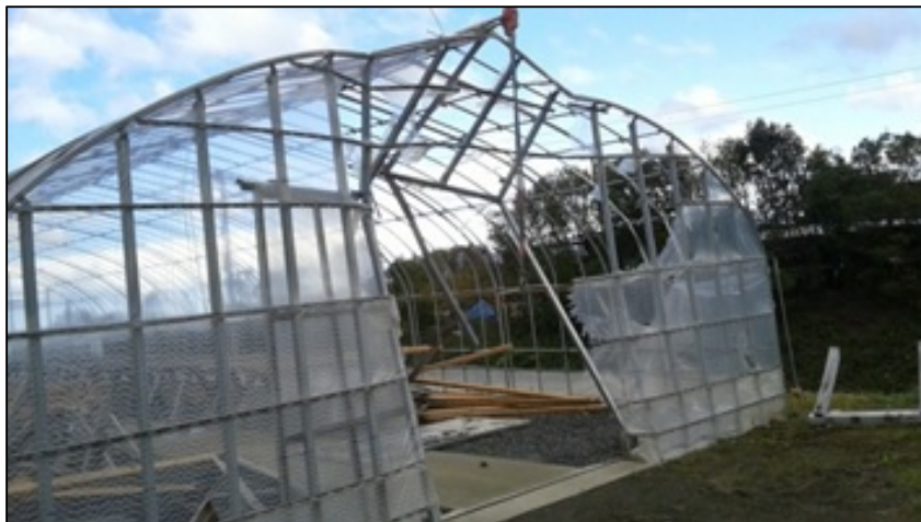
破損したパイプハウス（田辺市）
