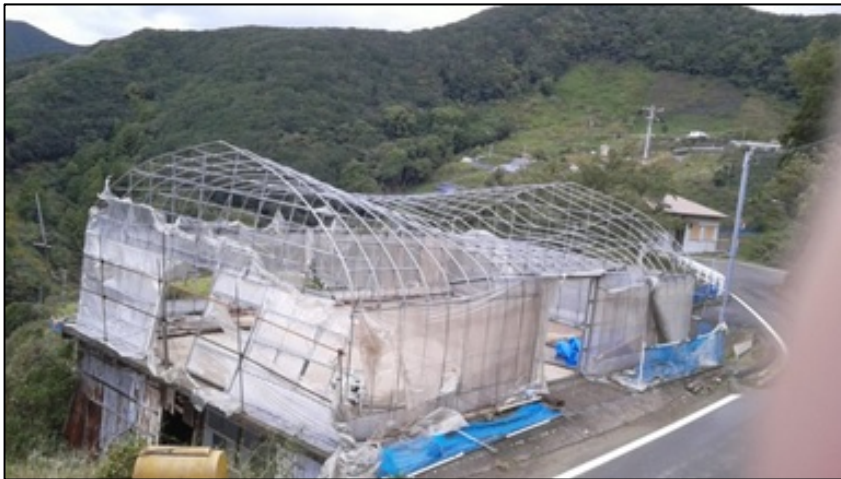
損壊したパイプハウス（田辺市）
