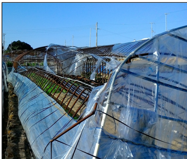
② 倒壊したパイプハウス
