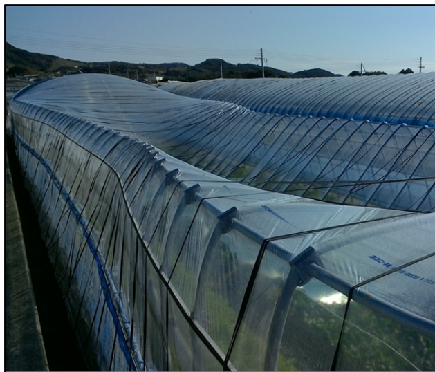
④ 鋼管の変形したパイプハウス
