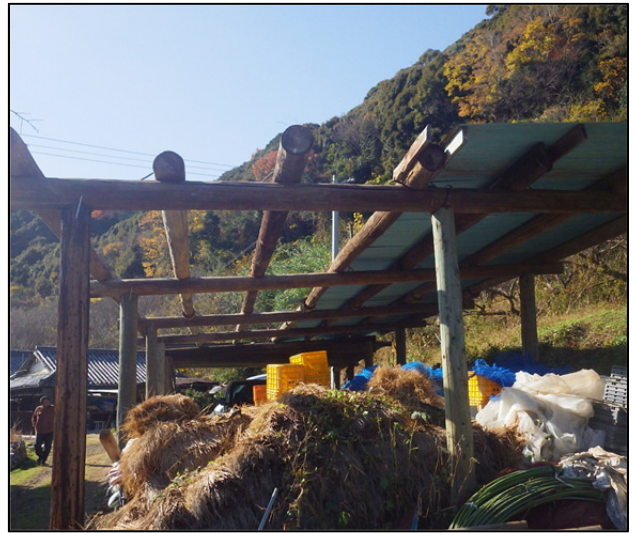
⑧ トタン屋根が飛散した作業小屋
