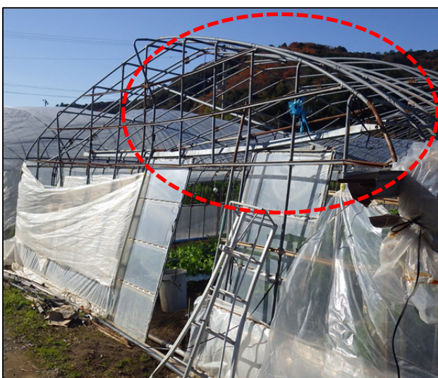
⑪ 鋼管の変形したパイプハウス
