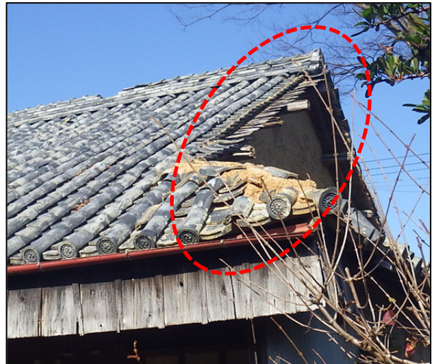
⑩ 屋根瓦が落下した非住家
