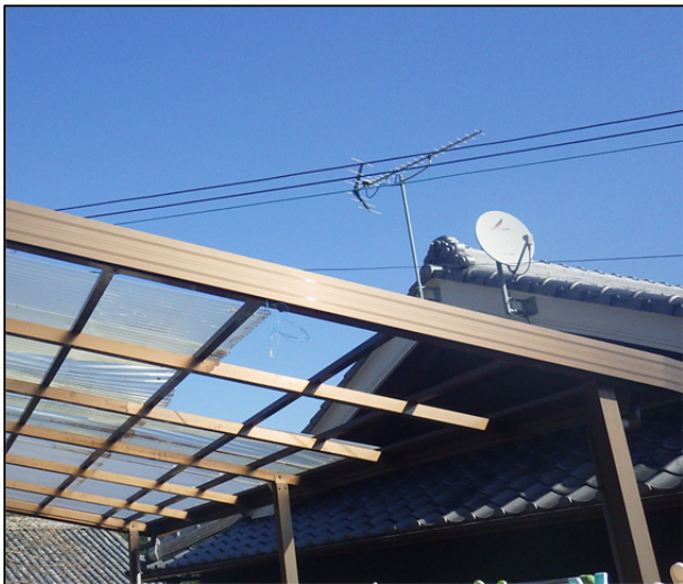
⑨ 屋根パネルの破損したカーポート
