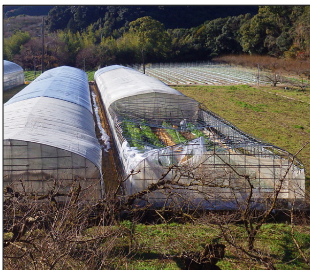
⑬ 鋼管の変形したパイプハウス
