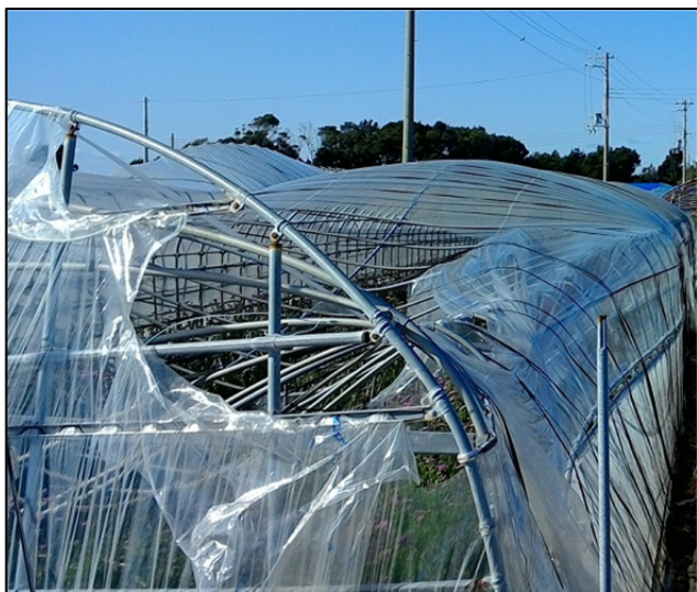
① 鋼管の変形したパイプハウス
