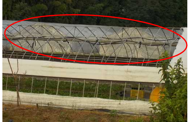
② 日除けネットが飛散したパイプハウス (西方向から撮影)
