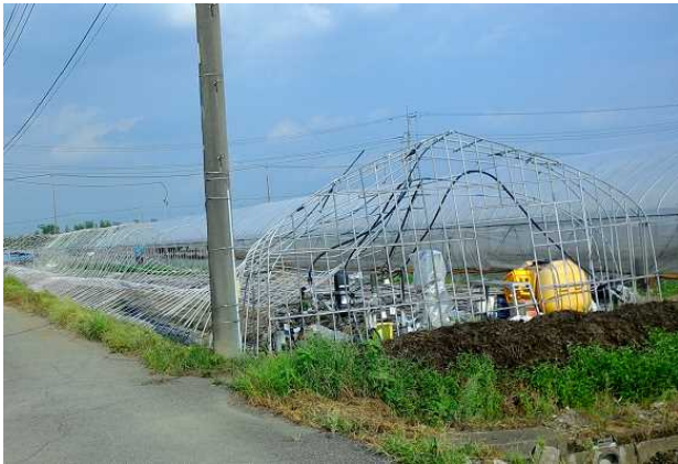
⑦ 変形したパイプハウス （西方向から撮影）
