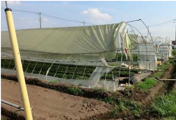
⑨ 変形したパイプハウス （北方向から撮影）
