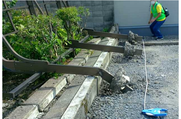
④ 倒壊したカーポート (北方向から撮影)
