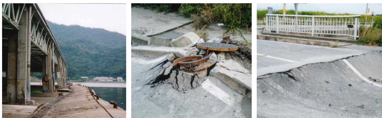
図：鳥取県西部地震の液状化被害
