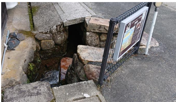
図 2 鹿野町の断層によってずれた用水路
