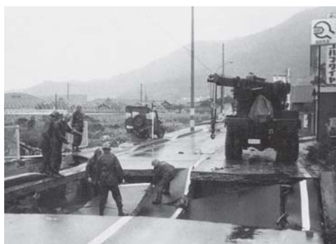
道路が陥没した（迎地地区）
