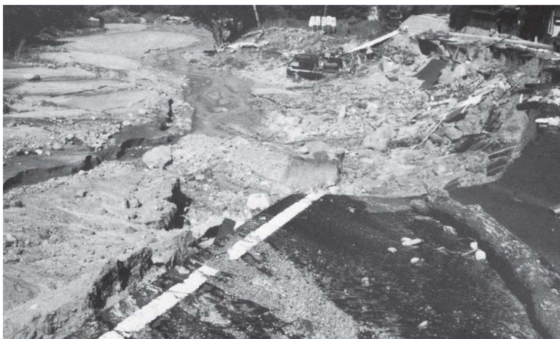
丸山付近の道路陥没
