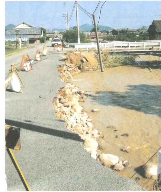
法面が浸食され電柱が傾いている市道石田造田線(石田地区)
