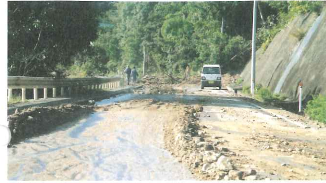
斜面が崩れ落ちた県道志度山川線(前山地区)
