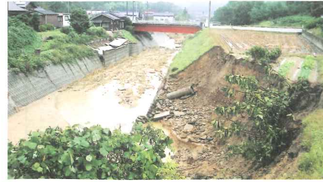
護岸ブロック上の農地ごと流失した津田川(田面地区)
