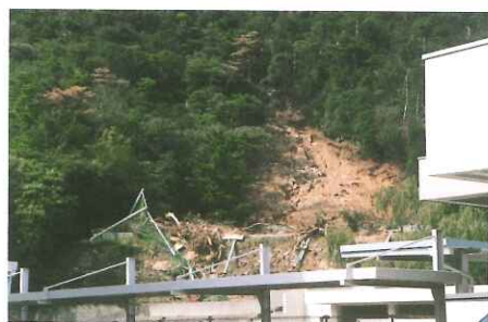
翼山の斜面が崩落し翼球場に土砂が(引田中学校裏)
