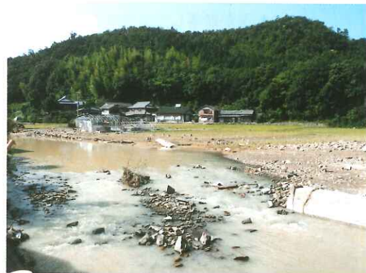
堤防が決壊した小海川(北谷下)
