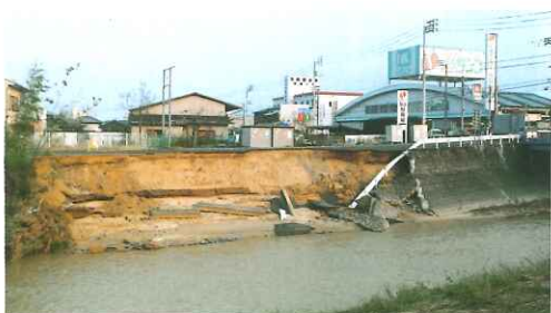
与田川沿いの道路が流失(川東地区)
