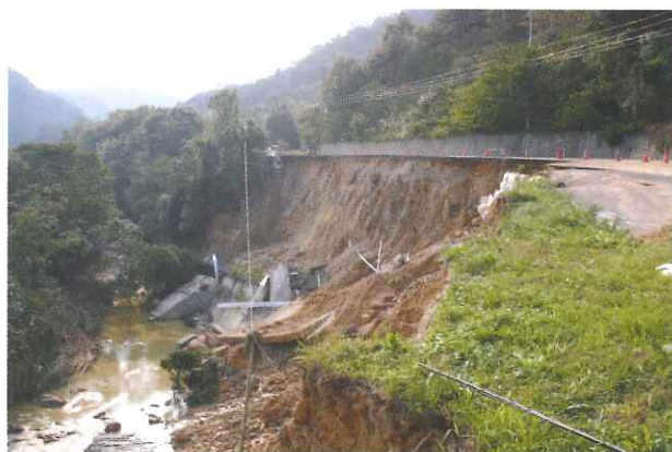
福栄地区では湊川の増水で道路が流失
