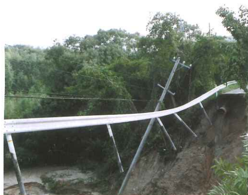
道路が流失し、香川用水の管が寸断される(様松地区)
