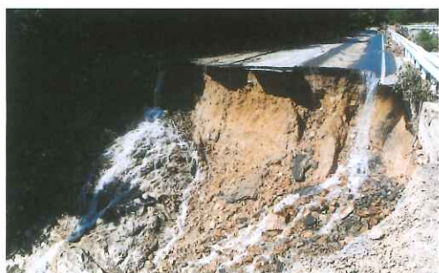
県道2号線崩落 山から流れ出る水が滝のように流れ落ちる(日下地区)
