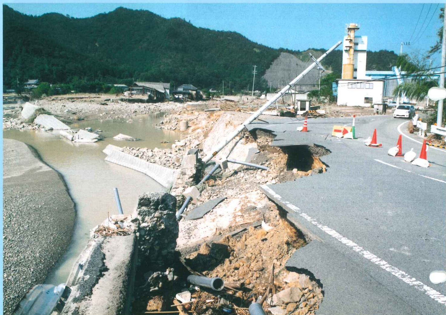
■白鳥地区の市道笠屋馬目崎線 —湊川と支流の合流点で道路が大きくえぐられた—
