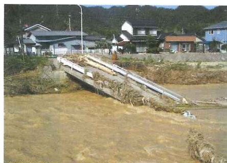
濁流に押し流された大社下橋(大社地区)
