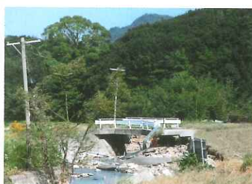
道路が陥没(南谷)
