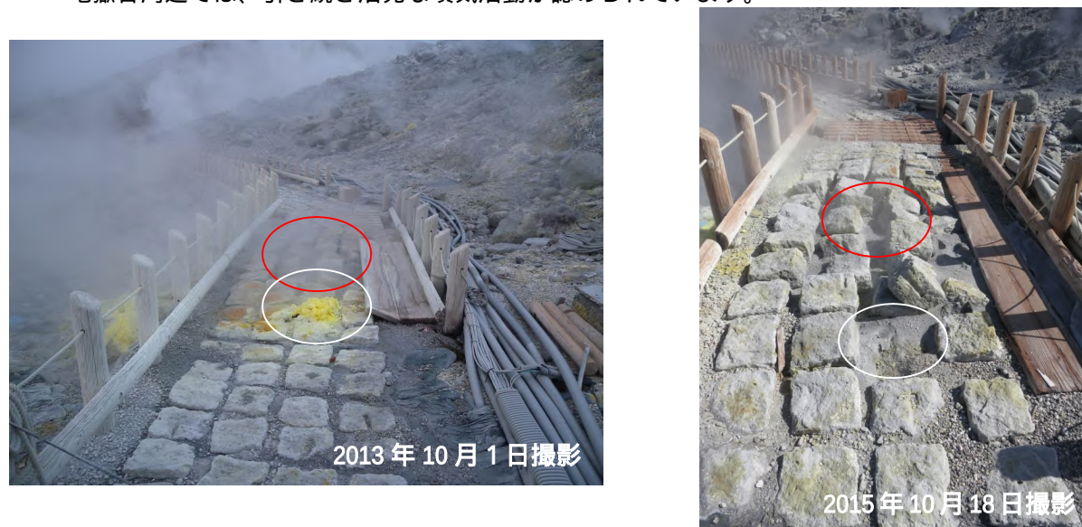
図 3 弥陀ヶ原 地獄谷遊歩道の状況
