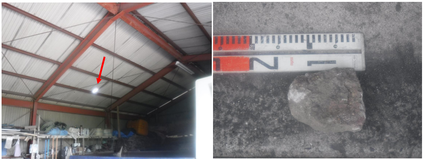
図 1-4 桜島 落下痕の近傍の建物で確認した屋根の被害写真及びその被害をもたらした岩石 （写真提供：鹿児島市）
