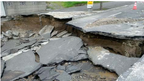
写真5 道路の陥没 (札幌清田区平岡地区)
