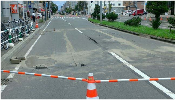
写真1 道路の亀裂等 (札幌東区元町地区)
