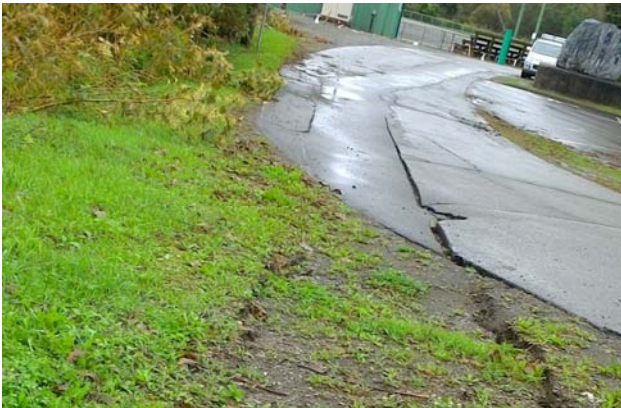
写真3 道路の亀裂 (日高地方日高町 町営富川球場付近)
