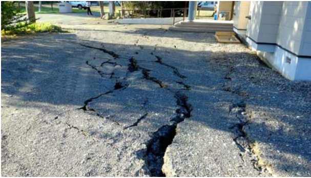
写真1 道路の亀裂 (その1) (厚真町鹿沼地区)
