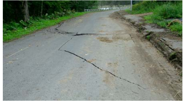
写真2 道路の亀裂 (その2) (厚真町鹿沼地区)
