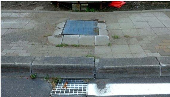
写真5 浮上した下水溝 (むかわ町松風地区)
