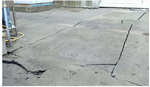
写真4 道路の亀裂 (むかわ町松風地区)
