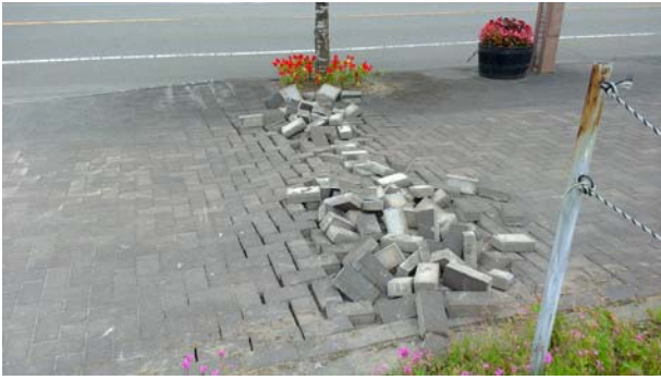
写真3 歩道のブロックの剥離 (厚真町京町地区)
