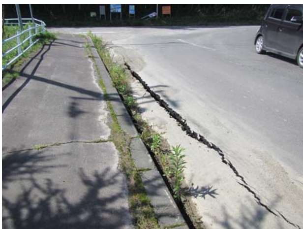
写真3 追分地区の道路の亀裂 (その1) (安平町追分地区)
