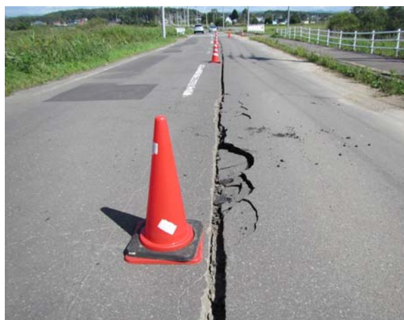
写真4 追分地区の道路の亀裂 (その2) (安平町追分地区)
