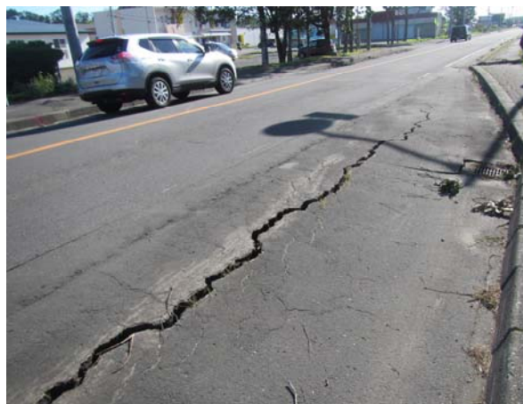
写真2 早来地区の道路の亀裂 (安平町早来地区)
