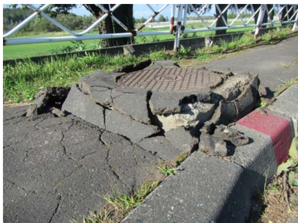
写真1 浮上したマンホール (安平町早来地区)
