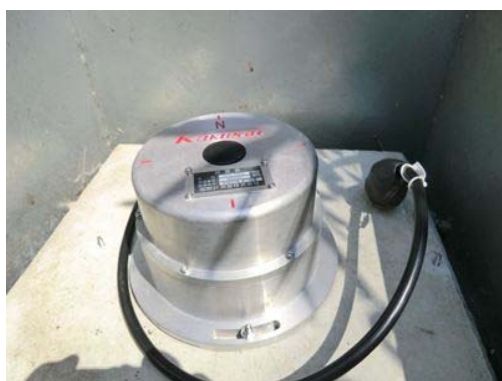
震度計台および計測部の状況
