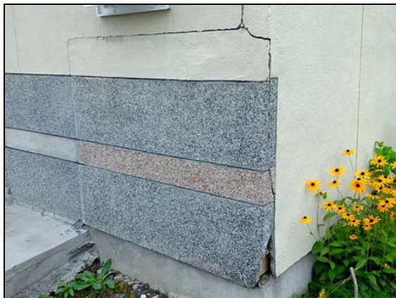
写真16 壁のひび割れ・剥離
