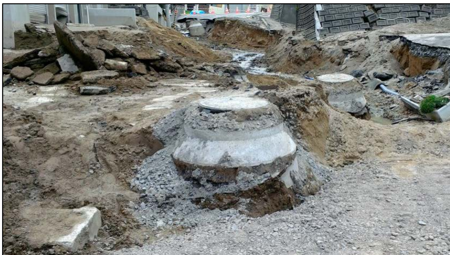
写真20 土砂流失による道路の破壊
