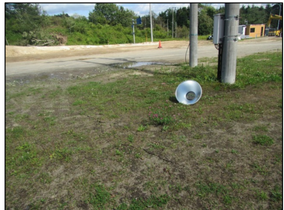
写真9 落下した照明
