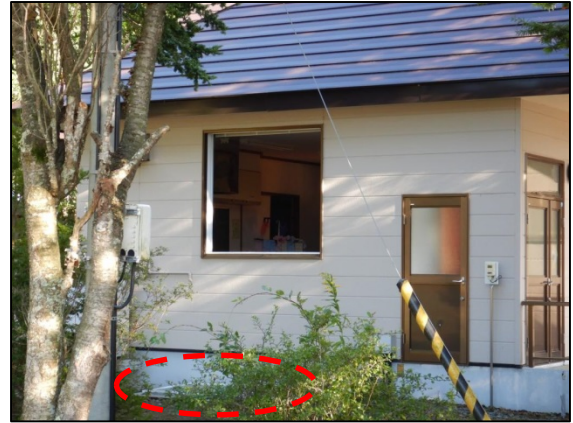
写真2 窓ガラスの落下 (赤破線部分に落下)
