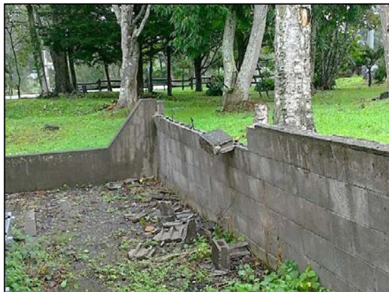
写真15 ブロック塀の崩れ
