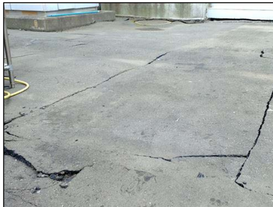
写真12 アスファルトの亀裂
