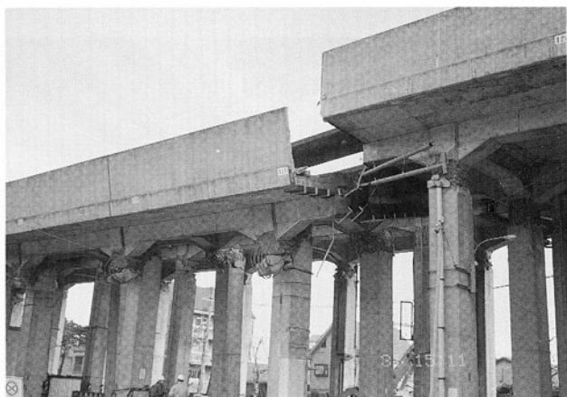
写真16. JRの高架橋脚破損 (神戸市灘区大和町1丁目)
