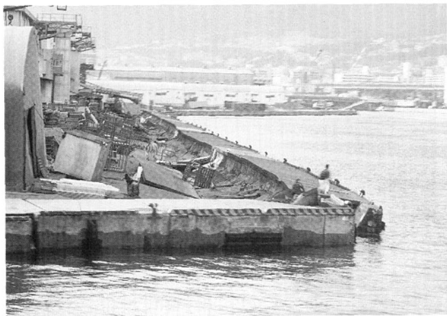
写真10．護岸ケーソンが南北に約2～3m移動している (神戸市東灘区深江浜町東部内貿埠頭)
