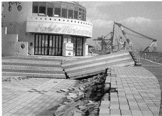
写真13. 六甲マリンパーク付近の陥没状況 (神戸市東灘区向洋町中9・六甲アイランド)
