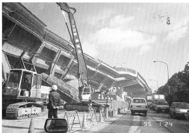
写真21. 阪神高速道路の倒壊
