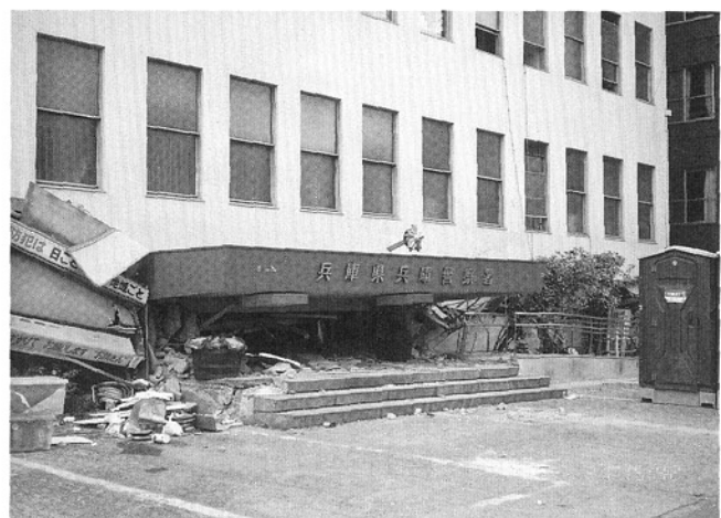
写真27. 1階部分が圧壊(兵庫警察署)
