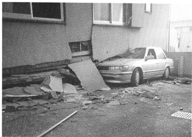
写真37. 1階駐車場の倒壊により押しつぶされた車 (神戸市東灘区)
