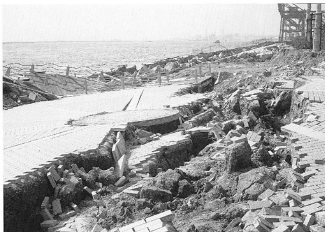
写真12. 六甲マリンパーク付近の遊歩道の陥没破壊 (神戸市東灘区向洋町中9・六甲アイランド)
