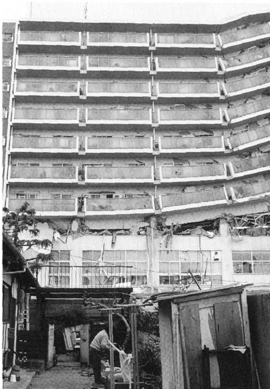
写真26. 3Fが潰れて上部の階が落ち込んでいる (西宮市津門大塚町)
