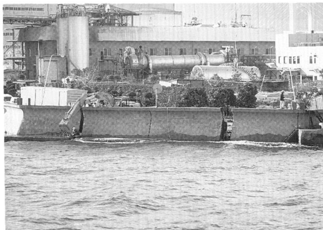
写真9．護岸ケーソンは大きいところで約1.5m移動 している(神戸市東灘区深江浜町)
