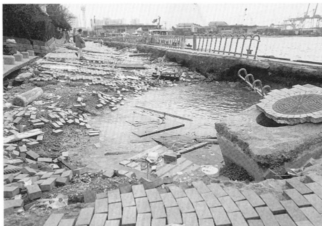
写真14. ケーソンが移動し、約1.5mの陥没(北公園西側) (神戸市中央区北公園・ポートアイランド)
