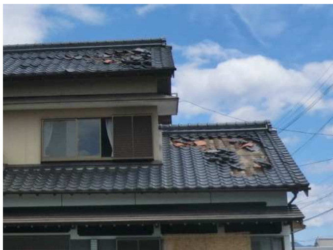
屋根瓦がめくれた住家
