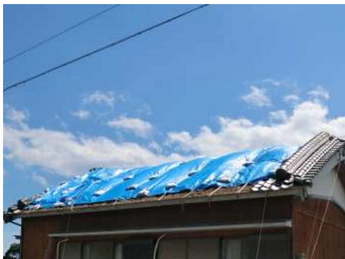
屋根瓦がめくれた住家
