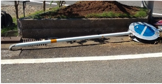
① 道路交通標識の支柱の倒壊
