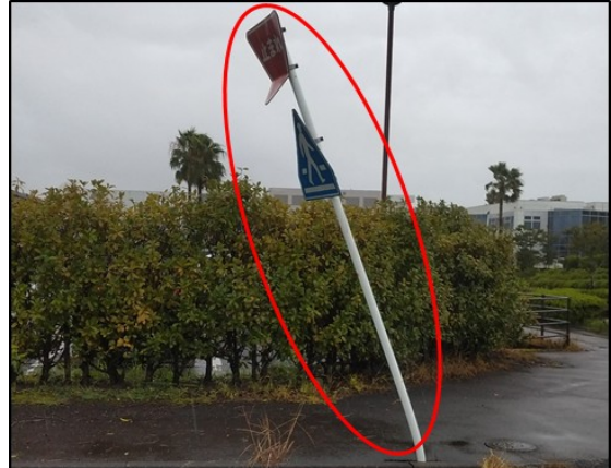
② 道路交通標識の支柱の傾倒
