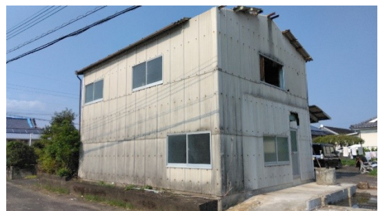
② 鉄骨造倉庫の屋根ふき材の飛散
