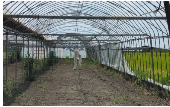
④ パイプハウス鋼管の変形
