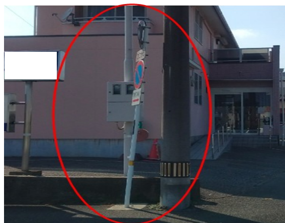
① 道路交通標識の支柱の傾倒
