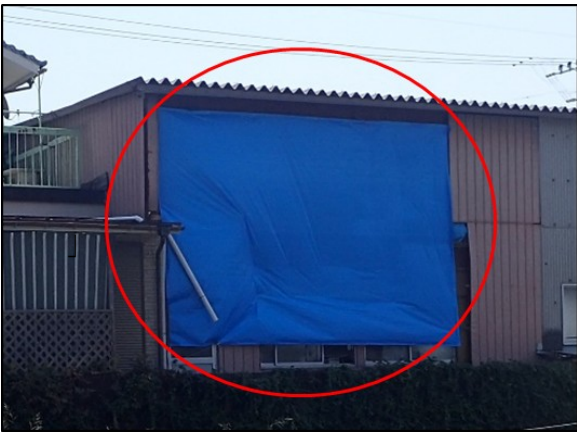
③ 非住家建築物の上部構造の変形
