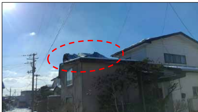
北側にめくれた車庫の屋根のトタン(北東から撮影)
