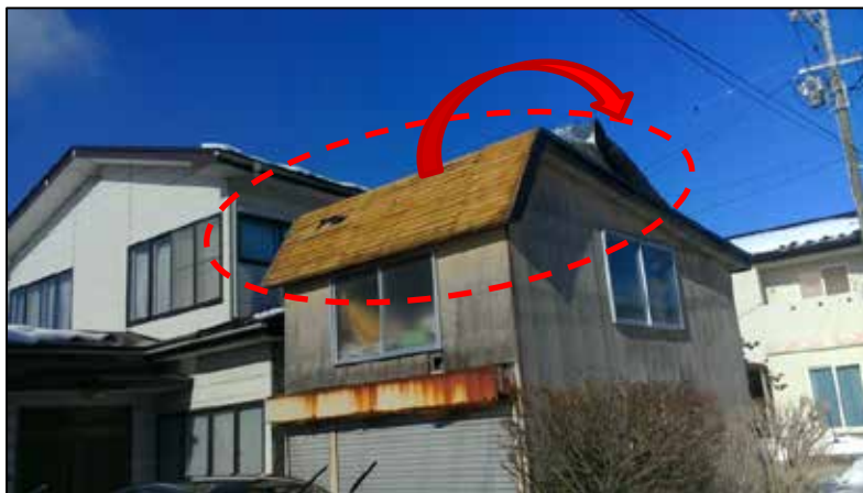
北側にめくれた車庫の屋根のトタン(南東から撮影)
