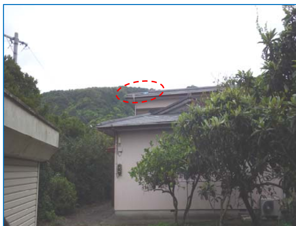
写真⑤ 撮影方向 北西 東面屋根の瓦が北東方向 40m に飛散した住家
