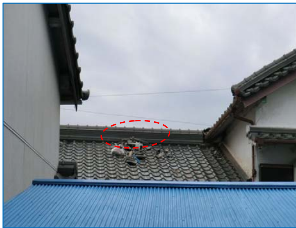
写真① 撮影方向 南 屋根瓦の一部がめくれた住家
