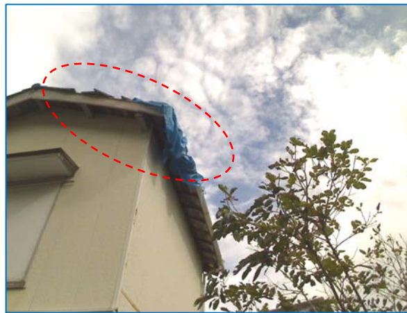
写真② 撮影方向 東 屋根瓦の一部がめくれた住家
