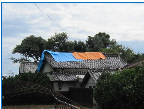
写真③ 撮影方向 南 屋根瓦が一部めくれた住家
