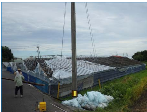
写真① 撮影方向 南東 ビニールがめくれ、北東方向に飛散した 7 棟のビニールハウス
