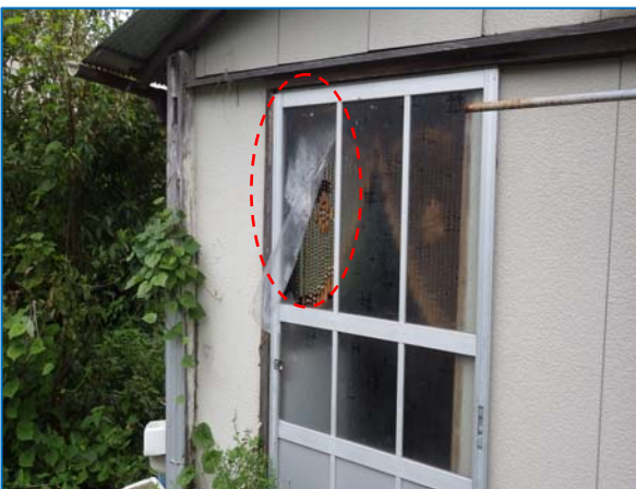
写真③ 撮影方向 北東 風圧で破損した（証言）住家西面の窓ガラス
