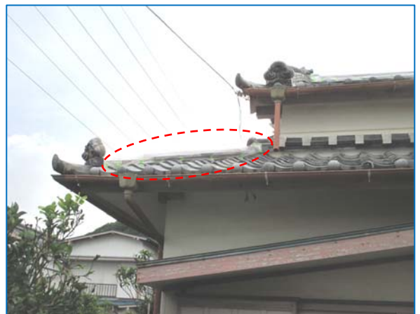
写真④ 撮影方向 北西 棟瓦の一部がめくれた住家
