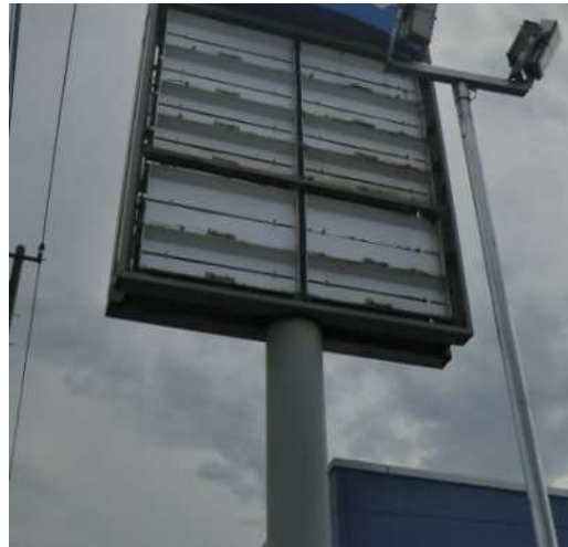
④ 破損した看板【北から撮影】
