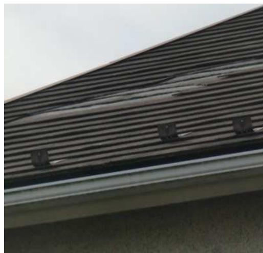
⑥ スレート瓦がめくれた住家【東から撮影】
