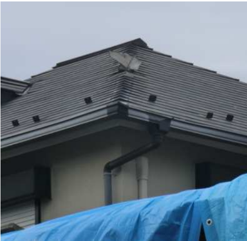
③ スレート瓦がめくれた住家【南から撮影】
