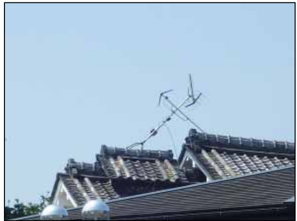
写真 六条2丁目 アンテナの傾いた住家
