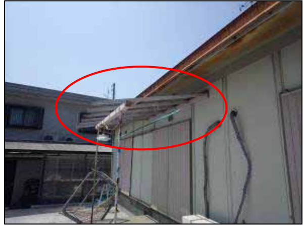
写真 六条1丁目 樹脂製のひさしが飛散した住家
