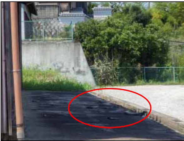
写真 六条2丁目 落下した住家屋根瓦
