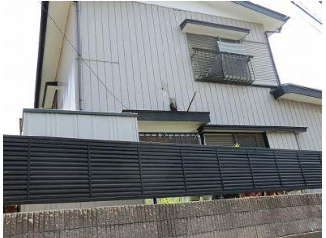
④飛散した角材により住家壁面損傷（西から撮影）
