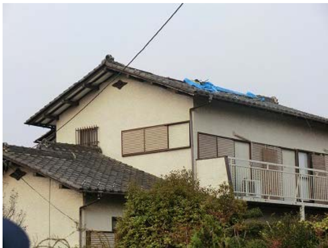
⑤東北地方太平洋沖地震により被災した屋根のブルーシートと瓦が飛散（南西から撮影）
