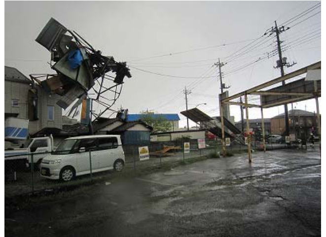
②傾いた看板と倒壊して吹き飛んだプレハブ建屋（北東から撮影） 【取手市消防本部提供】
