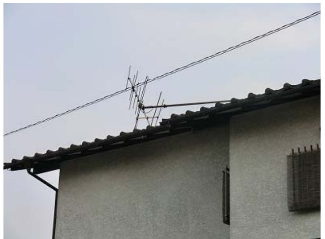
⑥TVアンテナが東に倒れる(突風によるものか飛散物によるものかは不明) （北から撮影）
