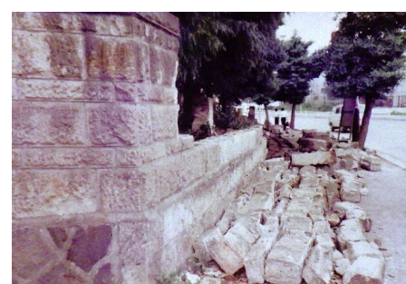
倒壊したブロック塀(仙台市)
