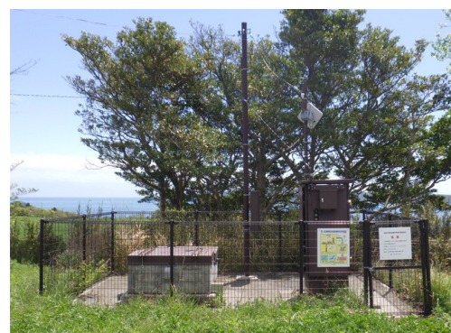
地震観測施設（石巻市）
