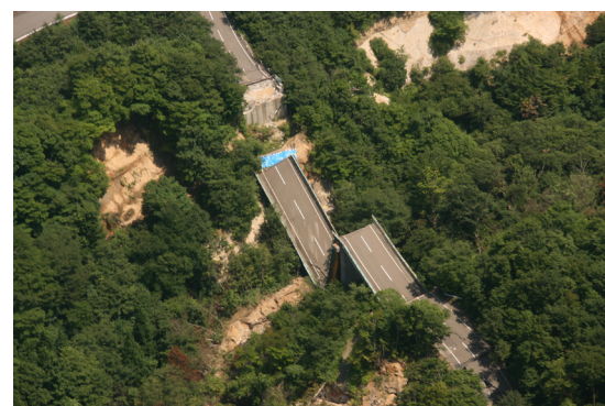
崩落した祭時（まつるべ）大橋 （岩手県一関市）
