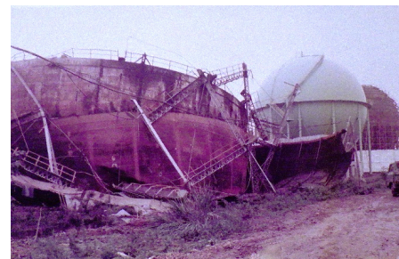
倒壊・炎上したガスタンク (仙台市)
