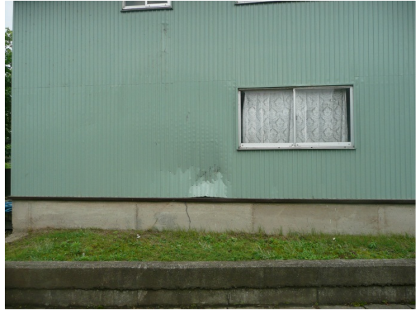
②住家（倉庫）北西側壁に何かぶつかった痕跡。 (北西から撮影)
