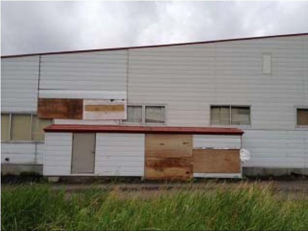
①非住家東側壁のトタンが東側へ約 10m 飛散。 (東から撮影)
