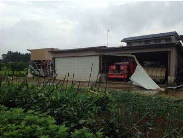
③左側倉庫の屋根が飛散し、左側倉庫のシャッターが 損壊。（北東から撮影）
