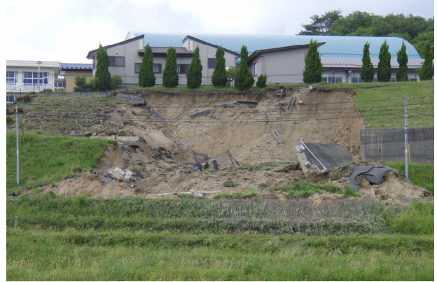
写真2. 栗原市鶯沢の高校敷地の法面崩落
