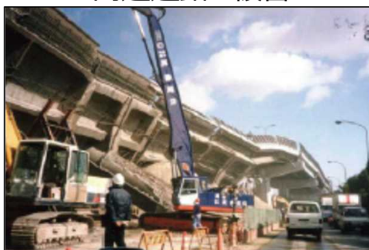
高速道路の被害
