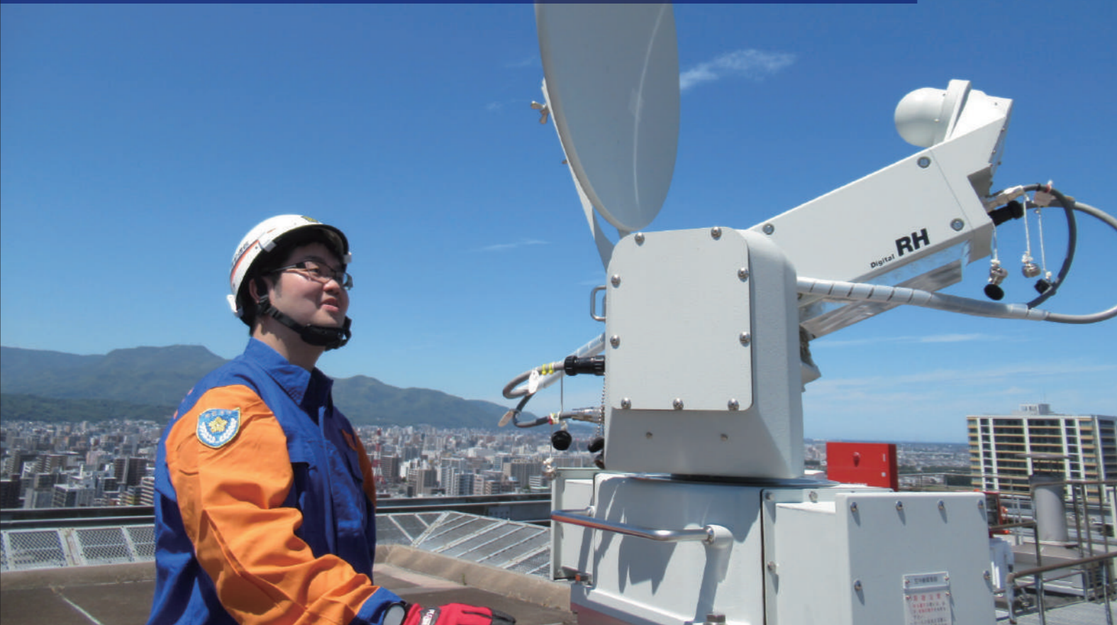
災害等の現場映像を関係部署へ生配信するための機器を設置している様子 [北海道警察情報通信部]
