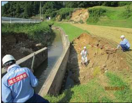
被災状況調査
