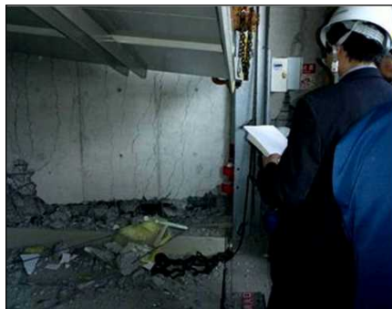
建物危険度判定
