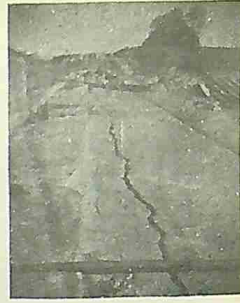
第 6 日和佐町築堤のすれ込みに依る龜裂
