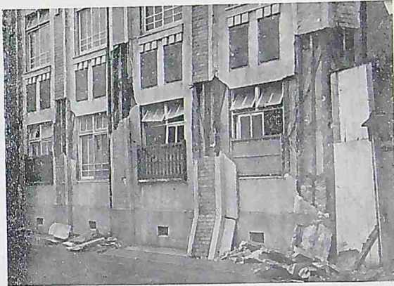
本町五丁目張りボテ式外装ノ破損
