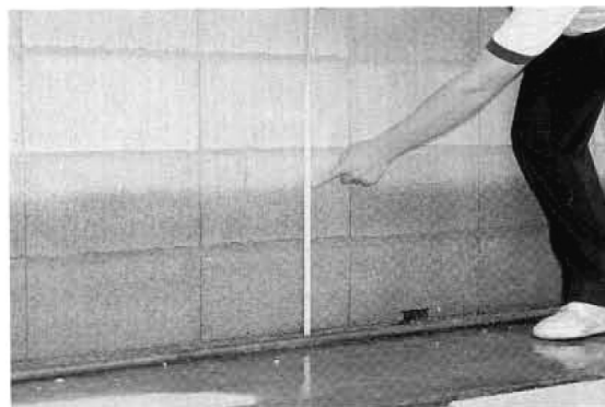
津波による浸水痕 (島根県八束郡美保関町、松江地方気象台)
