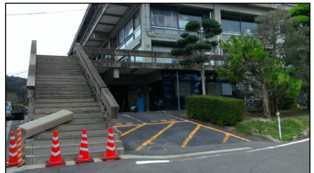
石階段の手すり落下(倉吉市)
