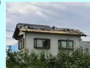
突風被害例 (住家の屋根瓦の飛散)
