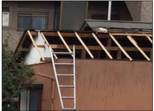
④ 屋根のトタンがはがれた住家 (北から撮影)
