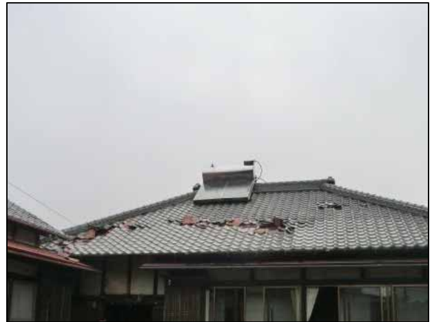
② 屋根瓦がめくれた住家 (南から撮影)
