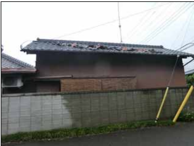
③ 屋根瓦がめくれた非住家 (西から撮影)
