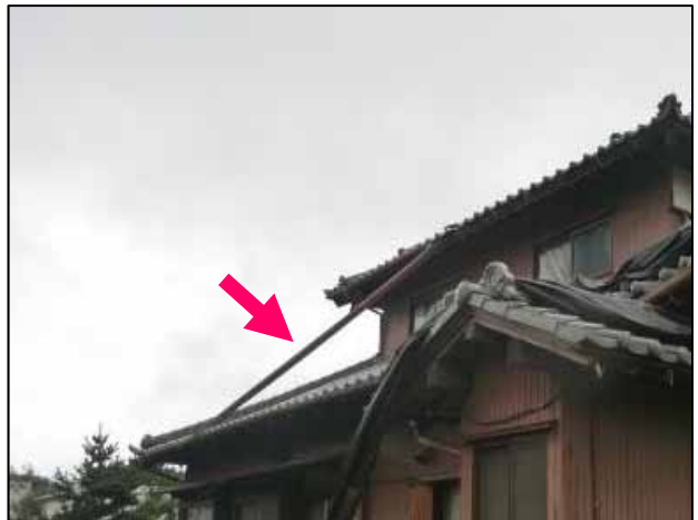
④ 雨どいが外れて垂れ下がった住家 (北西から撮影)
