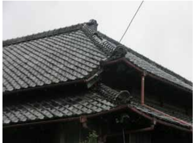
④ 屋根瓦がめくれた住家 (南西から撮影)
