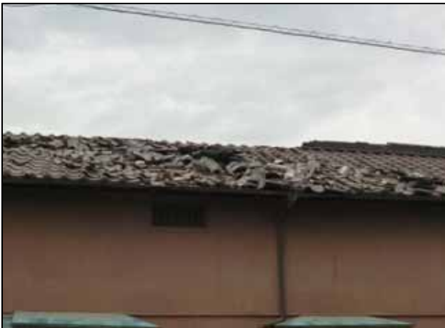
③ 屋根瓦がめくれた住家 (南から撮影)
