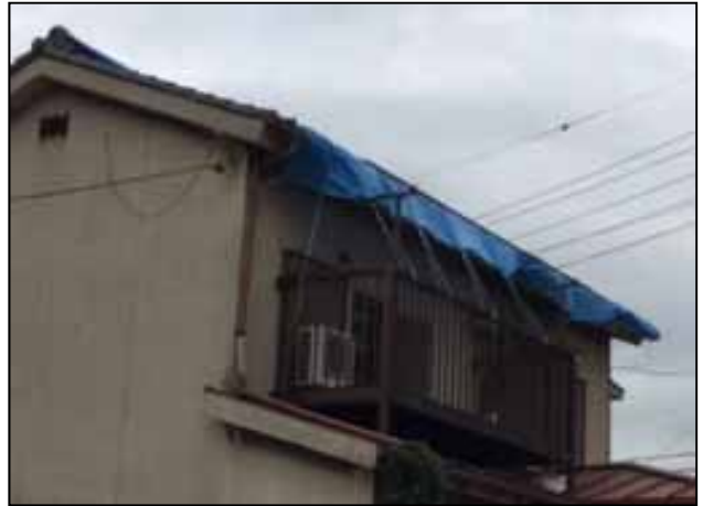
② 屋根瓦が飛散した住家 (南西から撮影)
