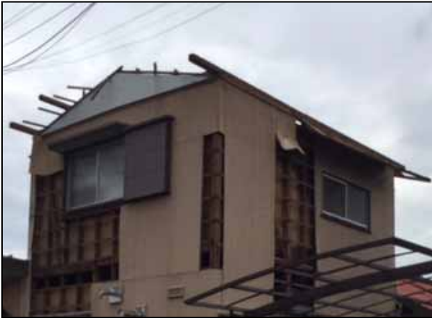
① 屋根が飛散し、壁がはがれた住家 (北東から撮影) ※被害としてはF2相当だが、周囲の状況からF1 として評定した
