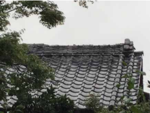
③ 屋根瓦がめくれた住家 (西から撮影)
