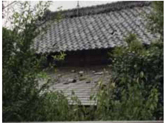
② 屋根瓦が落下した住家 (南西から撮影)
