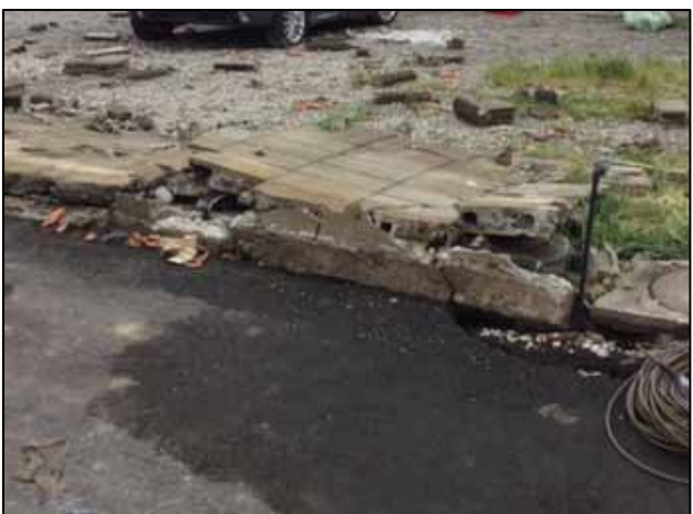
⑤ 倒れたブロック塀 (北東から撮影)
