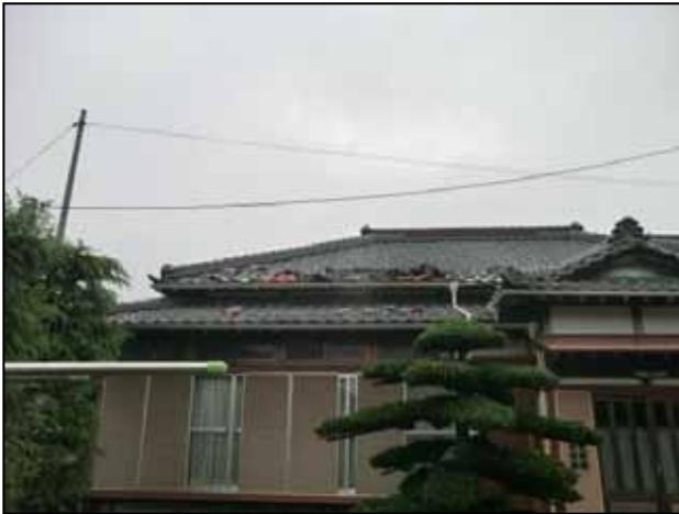
① 屋根瓦がめくれた住家 (南東から撮影)
