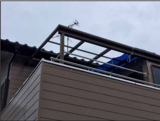
① ベランダの屋根が飛散した住家 (南東から撮影)
