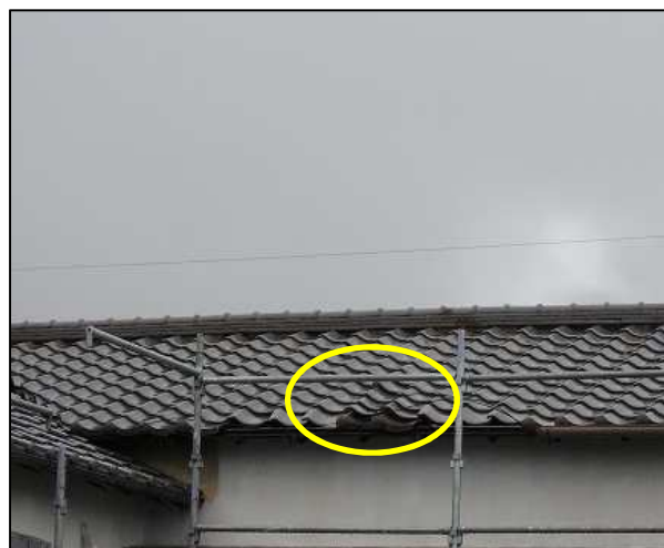
屋根瓦がめくれた住家 (南から撮影)
