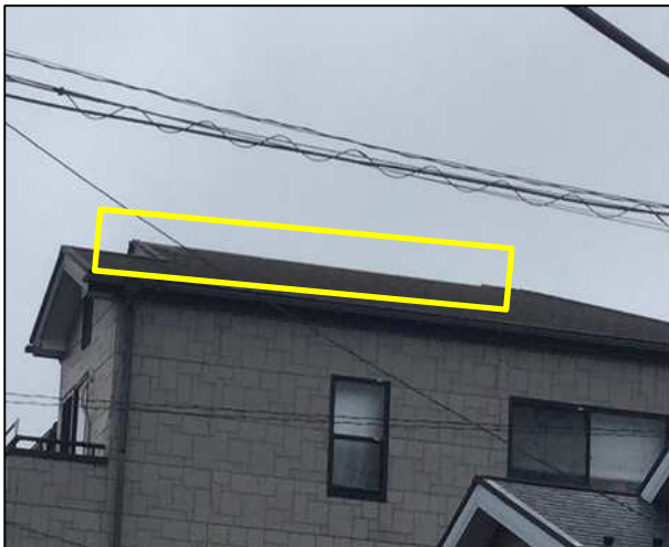
破損した住家屋根 (北から撮影)
