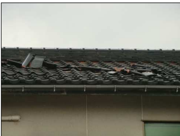
屋根瓦がめくれ落下した住家 【北西方向撮影】
