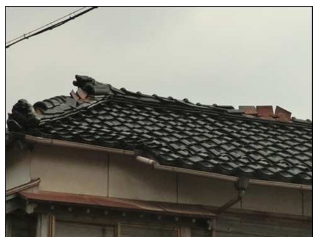
屋根瓦がめくれ落下した住家 【北東方向撮影】
