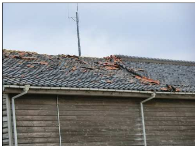
屋根瓦がめくれ落下した倉庫 【北西方向撮影】
