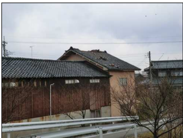
屋根瓦がめくれ落下した住家 【北西方向撮影】
