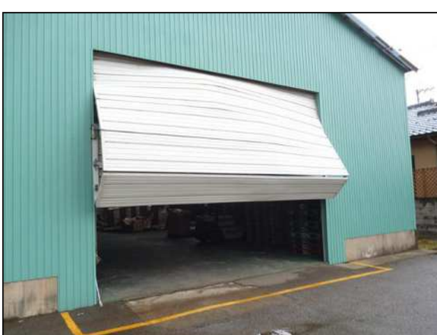
扉の一部が損壊した倉庫 【南西方向撮影】
