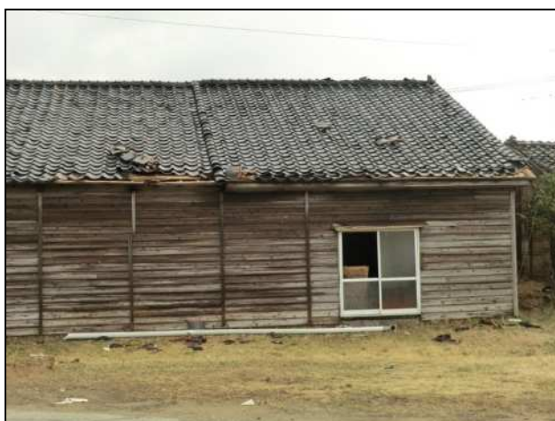
屋根瓦がめくれ落下した納屋 【北東方向撮影】
