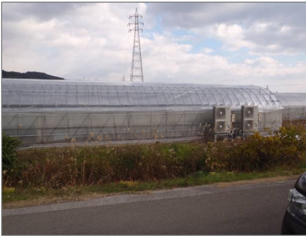
図 5 - 7 撮影場所⑦ ビニールがめくれたビニールハウス (修復済み)
