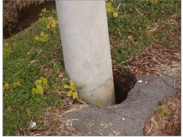
図 5 - 6 撮影場所⑥ 北方向に傾いた電柱の埋設部分
