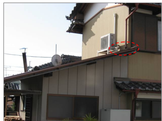
図 4 - 6 撮影場所⑥ 樋（筒状部分）が飛ばされた住家
