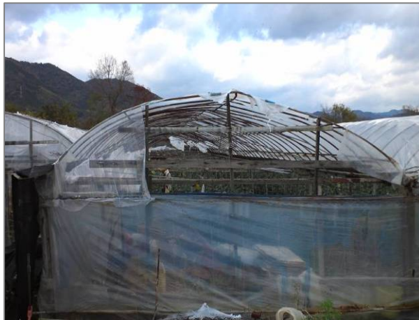
図 5 - 1 撮影場所① ビニールがめくれ、骨組みが変形したビニールハウス
