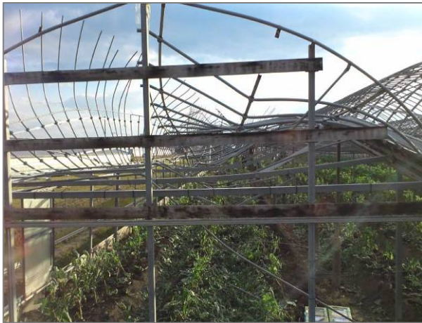
図 4 - 1 撮影場所① 上から押されたように変形したビニールハウス
