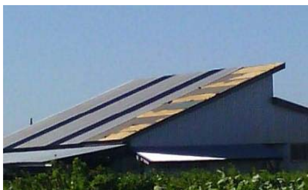
⑤ トタン屋根の一部が飛散した非住家 (埼玉県行田市馬見塚)
