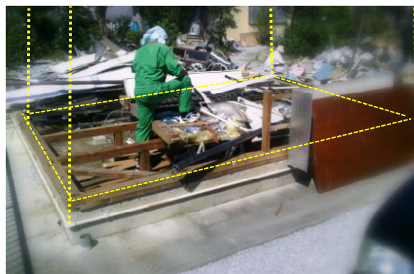
② 倒壊し、基礎と土台のみとなった住家 (埼玉県熊谷市西城)
