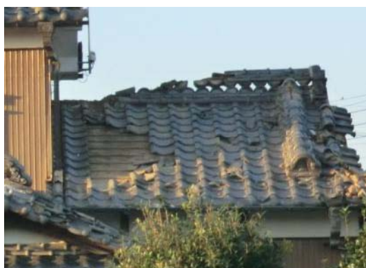
⑤ 屋根瓦が飛散した住家 (埼玉県熊谷市妻沼)
