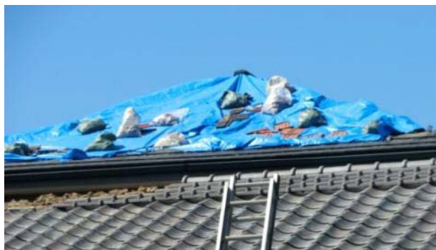
③ 屋根瓦が飛散した住家（修復作業中） (埼玉県熊谷市御正新田)
