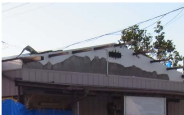
③ 屋根のトタンが飛散した非住家 (埼玉県熊谷市江波)
