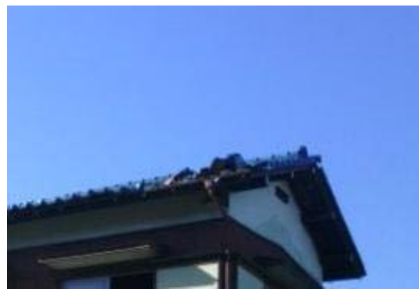
⑥ 屋根瓦がめくれた住家 (埼玉県熊谷市東別府)
