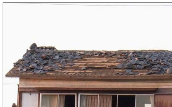
④ 屋根瓦が飛散した住家 (埼玉県熊谷市八ツ口)
