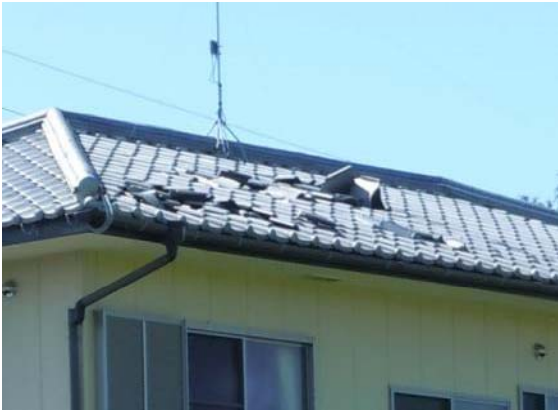
① 屋根瓦がめくれた住家 (埼玉県行田市中江袋)
