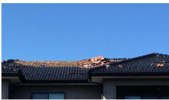
④ 屋根瓦が飛散した住家 (埼玉県熊谷市御正新田)
