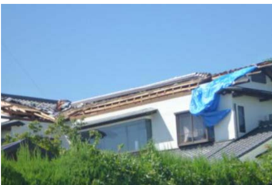
⑤ 屋根の一部と屋根瓦が飛散した住家 (埼玉県行田市南河原)
