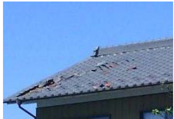
④ 屋根瓦がめくれた住家 (埼玉県行田市南河原)
