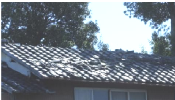
③ 屋根瓦がめくれた住家 (埼玉県行田市和田)
