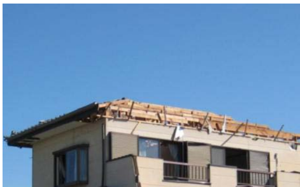
① 屋根の一部が飛散した住家 (埼玉県熊谷市四方寺)
