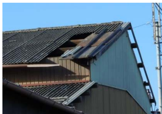
⑥ スレート屋根の一部が飛散した 非住家 (埼玉県行田市南河原)
