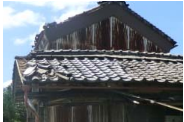
② 屋根瓦がめくれた非住家 [粟野町]
