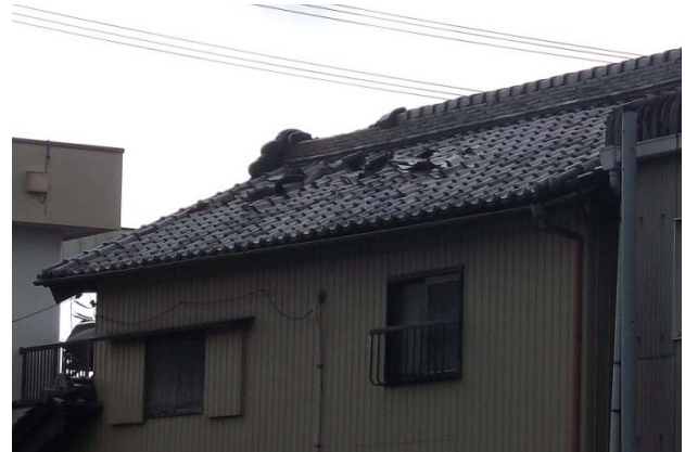
④ 屋根瓦がめくれた住家 [小俣町相合] 【伊勢市提供】
