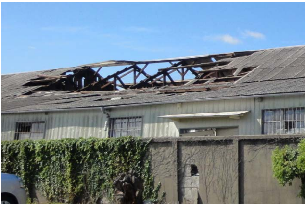
③ スレート屋根が飛散した非住家 [小俣町本町]
