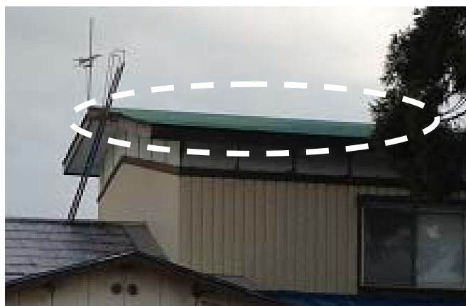
④2階屋根トタン全体が南東へ落下した住家 (北から撮影)
