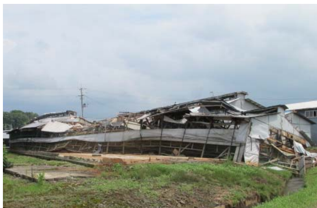
②南に倒壊した農業施設 (鶏舎) (北西から撮影)
