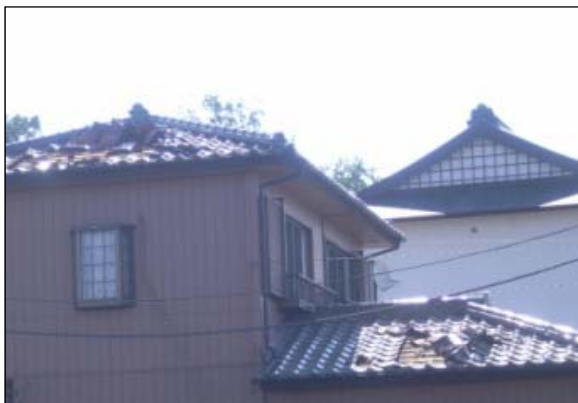
⑤ 住家屋根瓦の剥離 （群馬県邑楽郡邑楽町：北から撮影）
