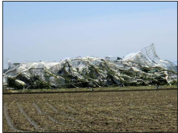
② 押し潰されたビニールハウス （栃木県足利市：北から撮影）
