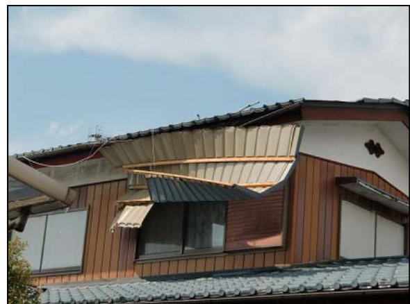
⑤めくれたトタン屋根 （白井市役所提供）
