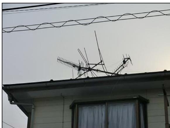
⑥倒れたアンテナ
