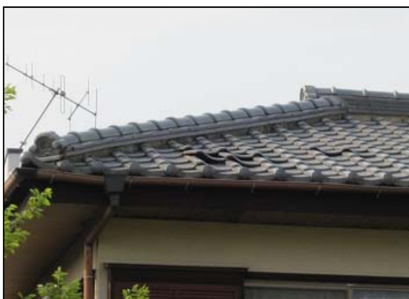
④剥離した瓦
