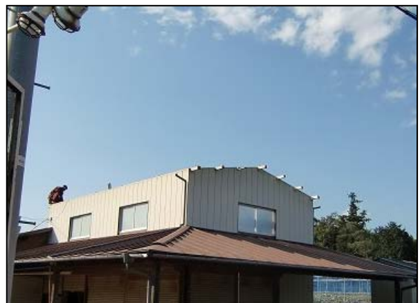
⑦屋根を飛ばされた梨直売所 （白井市役所提供）
