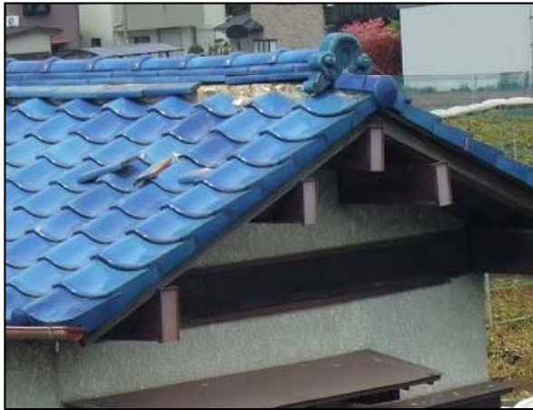
②剥離した瓦
