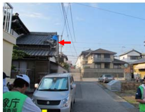
図 4-4 撮影場所④ 南側の屋根瓦の一部が捲れている。
