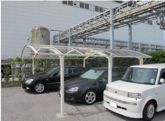
図 4-15 撮影場所⑮ カーポート屋根のほとんどが捲れ、飛散した。
