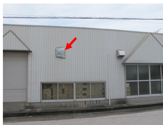
図 4-6 撮影場所⑥ 西側の壁が一部破損している。写真では簡便な補修が施されている。
