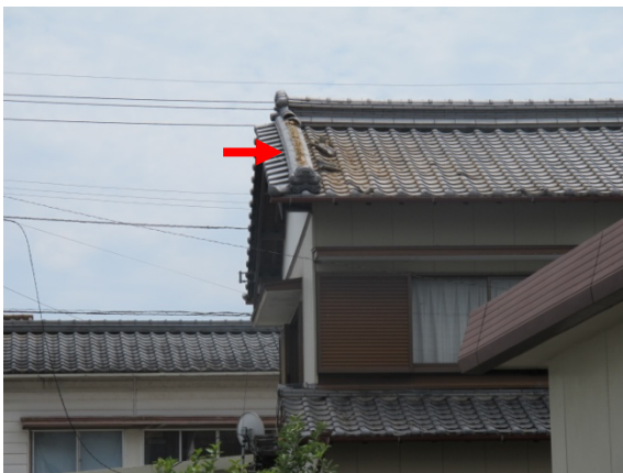
図 4-11 撮影場所⑪ 北側の屋根瓦が一部捲れている。
