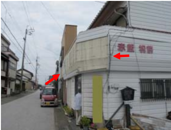
図 4-9 撮影場所⑨ 南側の外壁（トタン）が捲れ、東へ飛散している。
