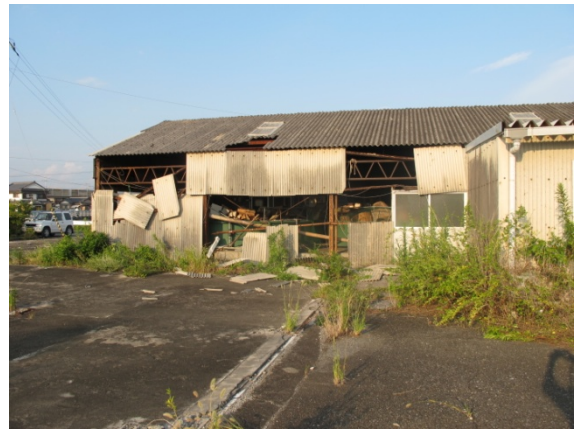
図 4-14 撮影場所⑭ 倉庫の西側の外壁が捲れ、北東方向 10～20mにわたって飛散している。
