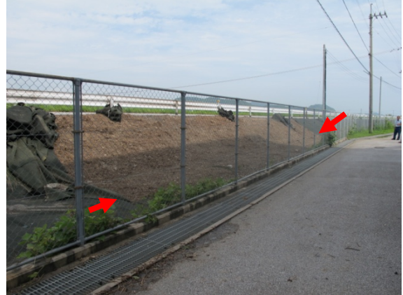
図 4-16 撮影場所⑯ 幅 24m の防草シートが北東側に捲れている。
