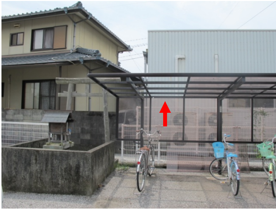
図 4-7 撮影場所⑦ カーポート屋根の南東側の一部が捲れている。
