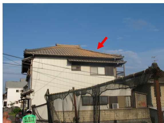
図 4-5 撮影場所⑤ 西側の屋根瓦の一部が捲れ、西方向に飛散していた。
