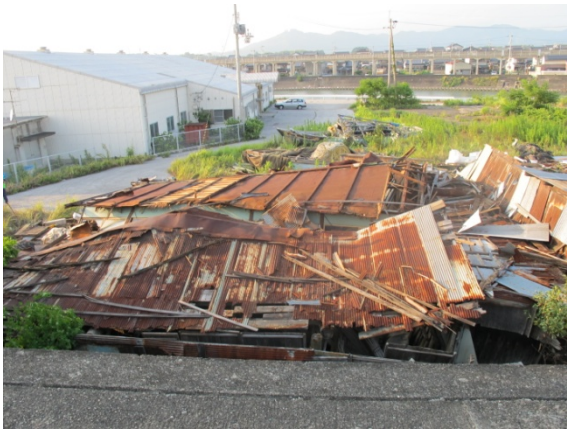
図 4-13 撮影場所⑬ 倉庫が北側に倒れ、飛散している。
