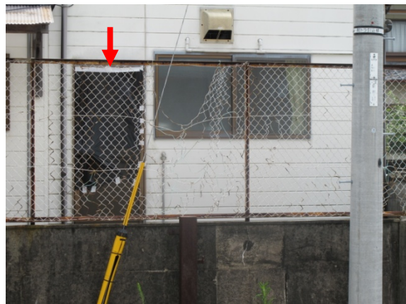
図 4-12 撮影場所⑫ 北側にある扉のガラスが破損している。
