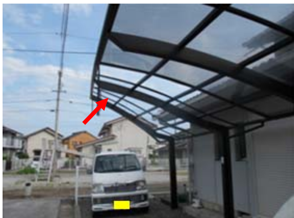
図 4-1 撮影場所① カーポート屋根の北北東部の板が捲れている。
