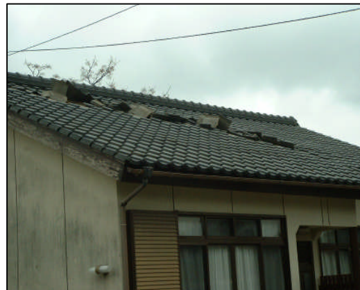
瓦のめくれ(南西側から撮影)
