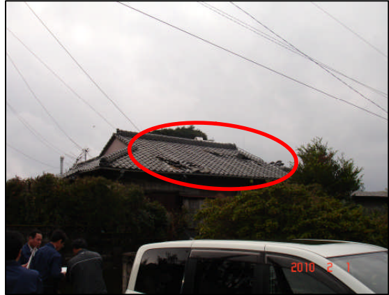
民家北側の瓦が一部落下。 (南東側から撮影)
